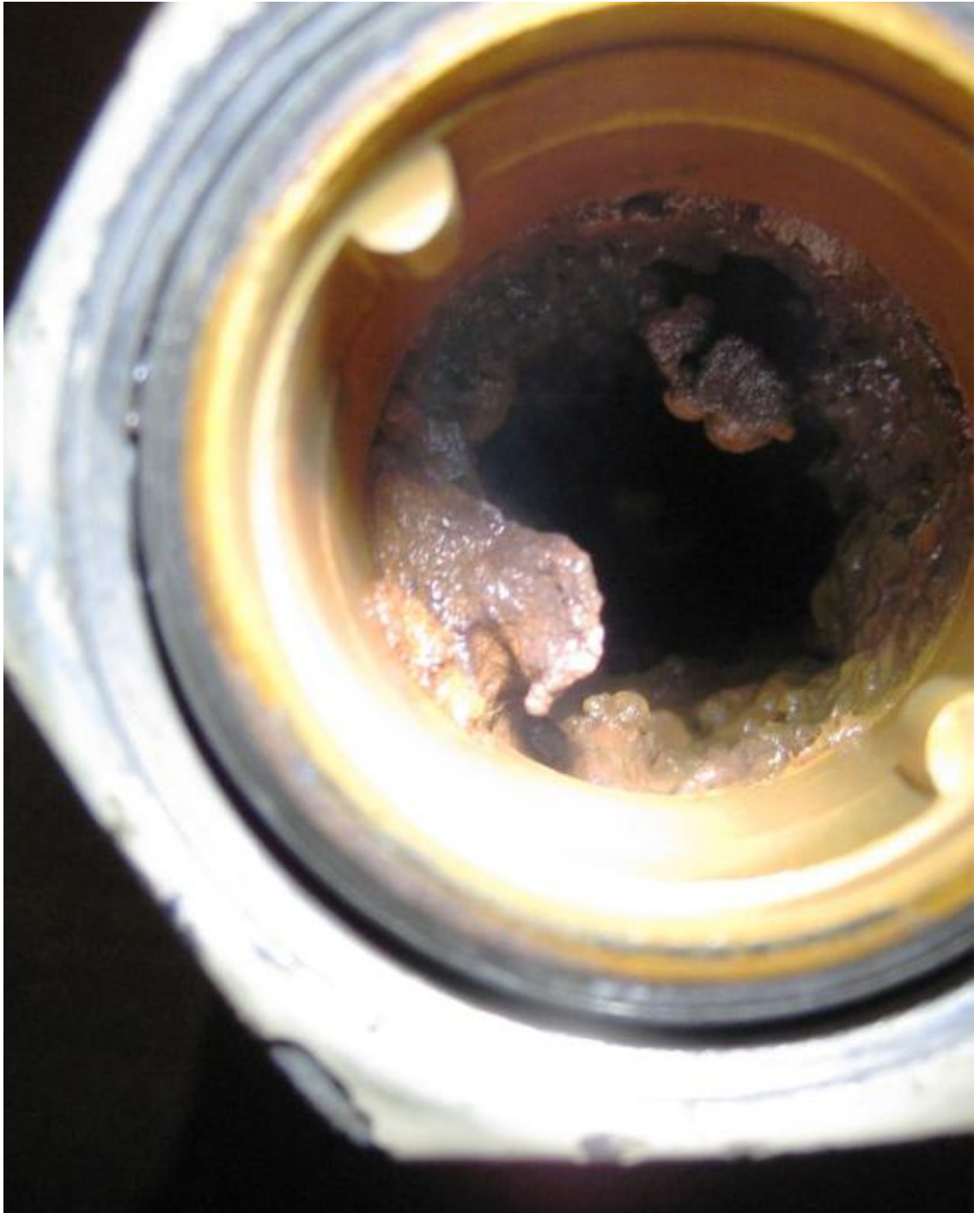
Р.С. Состояние контрольной трубки (фото №5) через 18 месяцев после демонтажа витализаторов воды
