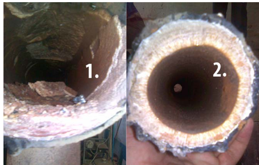
Срезы труб теплообменника до установки витализатора biobird.
